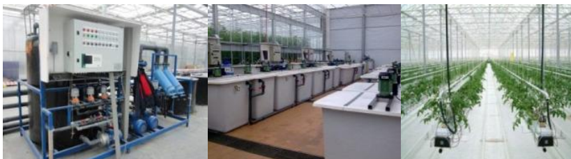
Рис. 17. Растворный узел с системой полива
